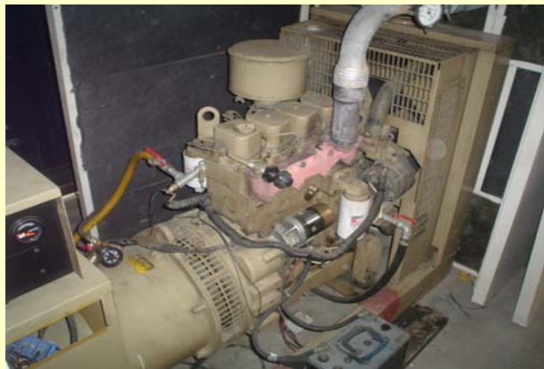
Planta de 40 kW utilizada en los ensayos
